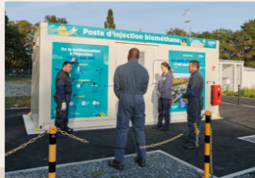
Poste d'injection biométhane
